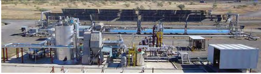
Vista de instalaciones de almacenamiento térmico de PSA.
