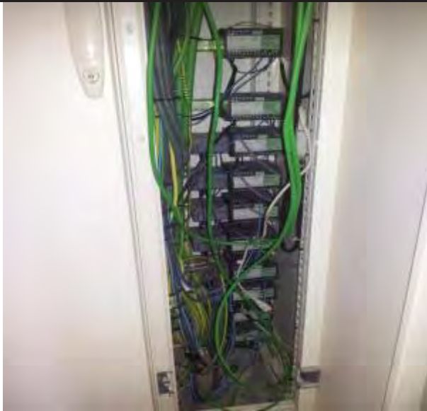
Vatímetros instalados para analizar los consumos eléctricos.
