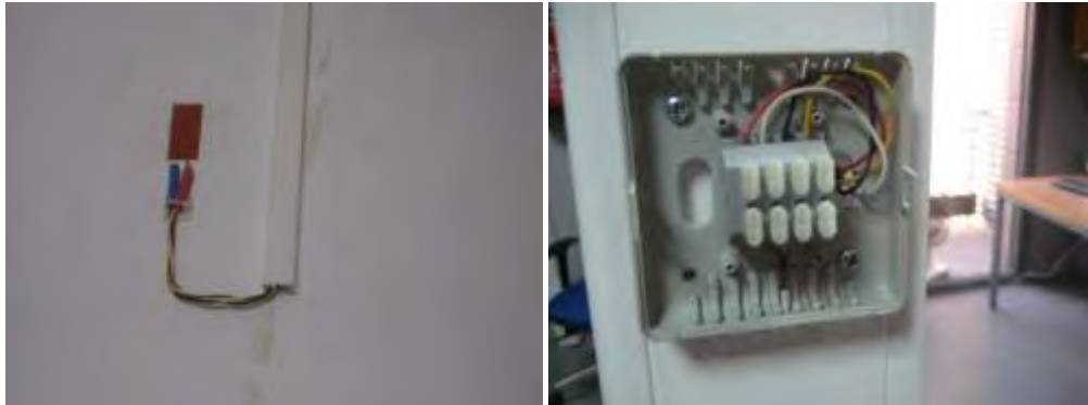
Temperatura de superficie y sensor de tipo PT-100 aéreo.
