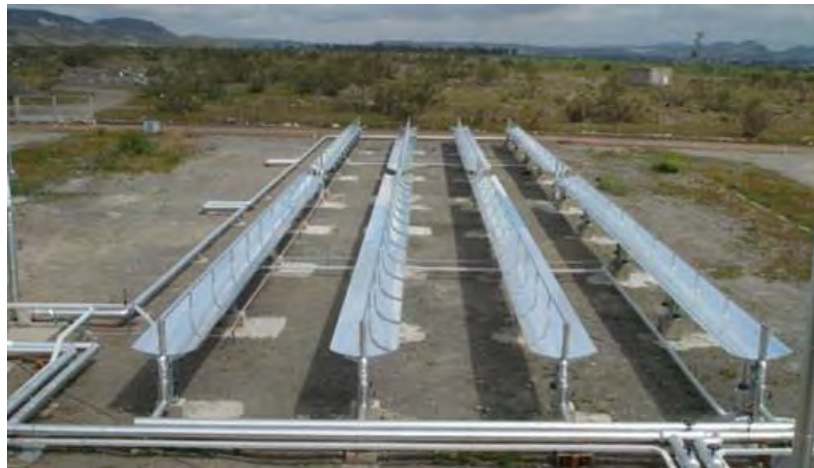
Campo de captadores solares para poligeneración
