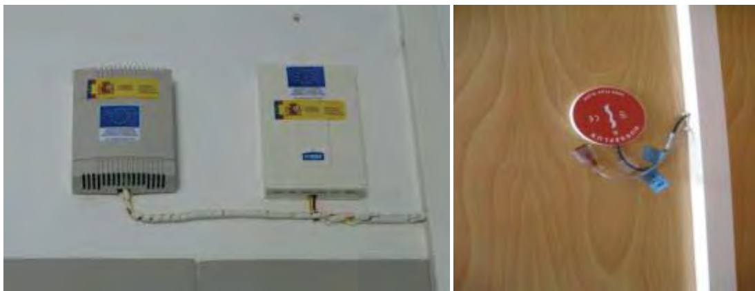
Sensores de humedad relativa, CO2 y flujo térmico.
