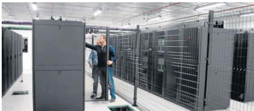
Dos técnicos supervisan una de las máquinas del centro de datos de la Universidad de Almería.
