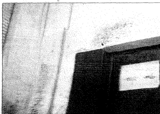
■ Exigen, al menos, que se solucionen las humedades. / LA VOZ
