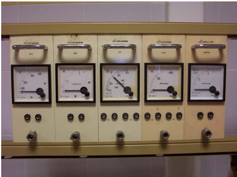
Figura 1. Instrumentos de medida analógicos utilizados en el laboratorio: voltímetro, amperímetro, fasímetro, vatímetro y tacómetro.
