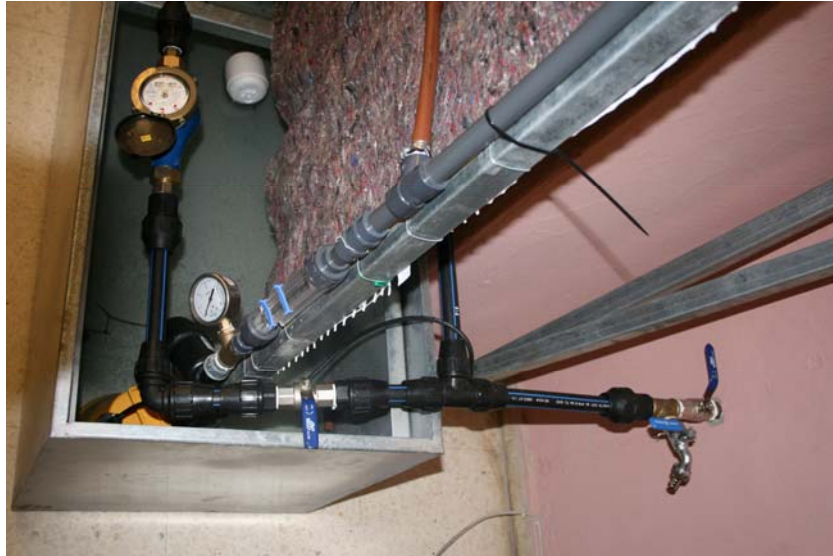
Figura 3: Imagen detalle de los aparatos hidráulicos de medición incluidos en la instalación del jardín vertical con un objetivo docente.
